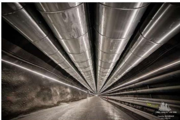
Équipement ventilation et éclairage complet descenderie
