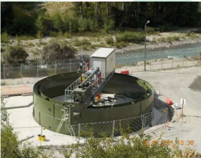
Station de traitement des eaux Villarodin-Bourget Modane
